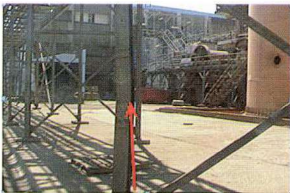
Figure 9 : Flambement des poteaux.
