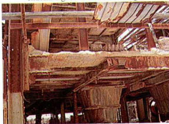
Figure 7 : Altération profonde des poutres et des planchers.
