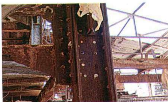
Figure 6 : Manque de boulons et endommagement des assemblages.
