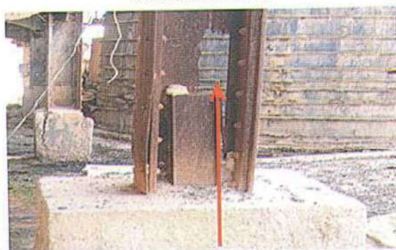
Figure 5 : Forte dégradation et corrosion très avancée des pieds de poteaux.
